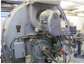
Figure 10 — Réseau de distribution de chaleur à l'eau et l'air chaud et bouilloire à l'eau chaude.
