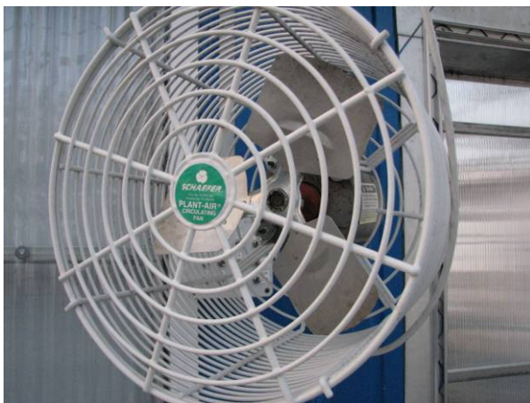
Photo 5 : Pales et grilles de ventilateur horizontal bien nettoyées.
