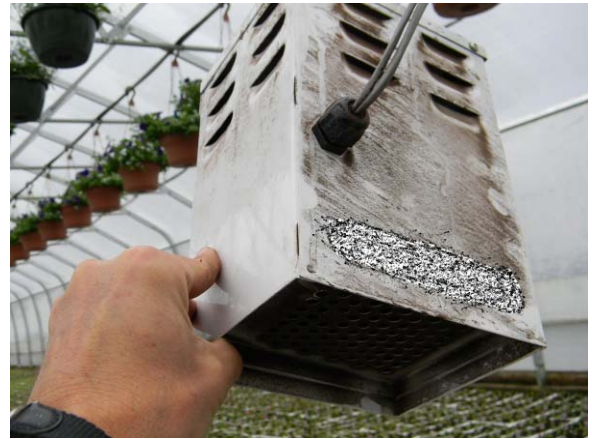
Photo 2 : Cage de sonde climatique à nettoyer.
