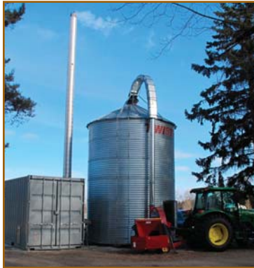
Installation de chauffage à la biomasse (Photo : Ian Pickering)
