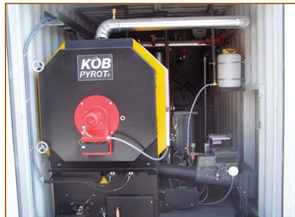
Chaudière à biomasse (Photo : Ian Pickering)
