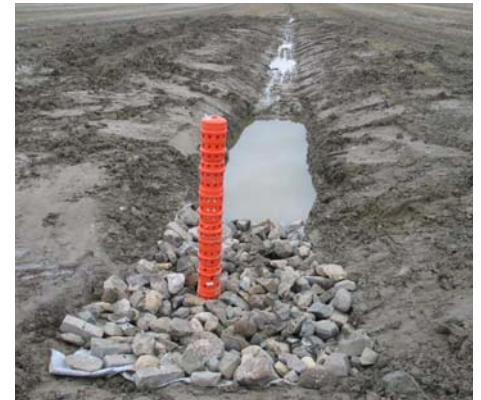
Source: Mikael Guillou (MAPAQ) Avaloir avec bassin de sédimentation dans un fossé
