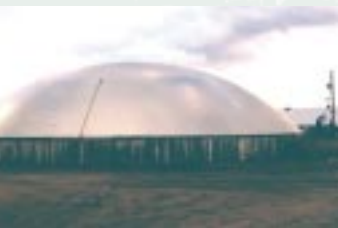
Toiture gonflée de type Envirodôme de 31 m de diamètre.
