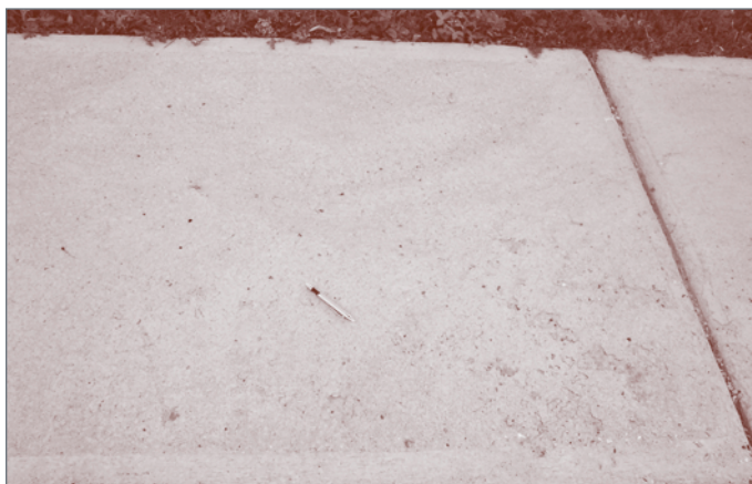
Figure 2b - Écaillage modéré d'une dalle de béton
