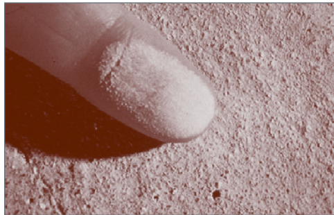
Figure 1 : Empoussièrement de la surface d'une dalle de béton
