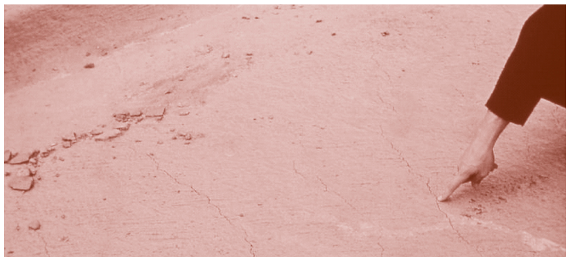
Figure 1 - Fissures de retrait plastique
