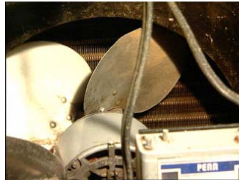
Figure 22. Il faut favoriser un bon échange entre l'air et les ailettes du condenseur du refroidisseur
