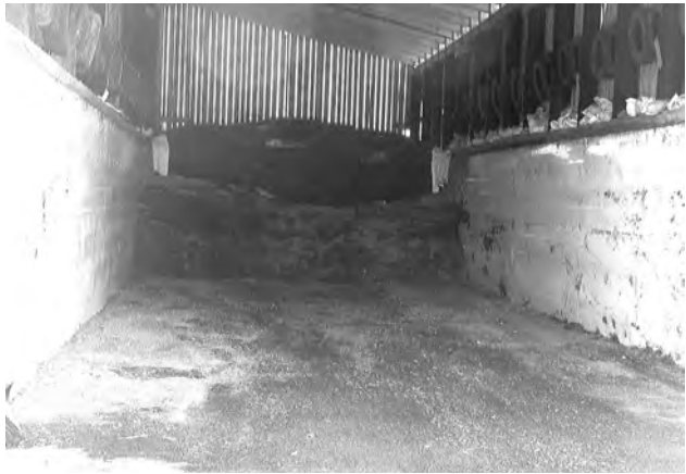
Figure 12. Recouvrement étanche des murs en bois Photo : Luc Dubreuil, MAPAQ
