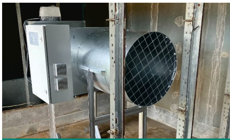
Chauffage électrique installé dans un bousquet.
