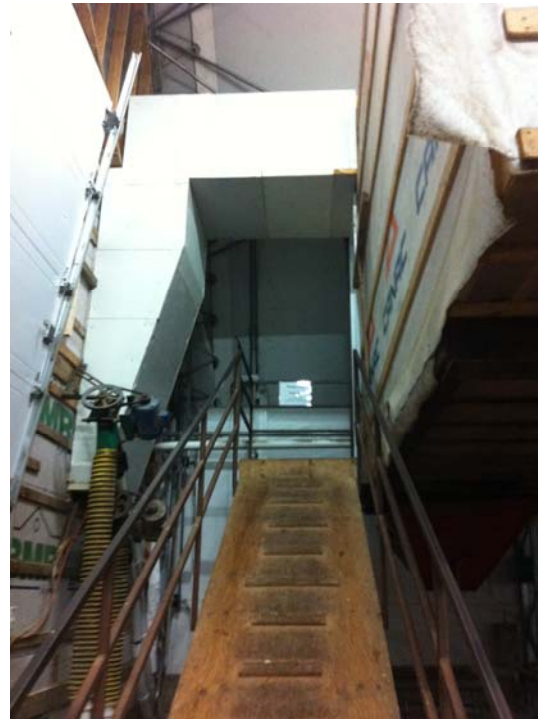
Figure 8 Conduite isolée à l'entrée de la pouponnière
