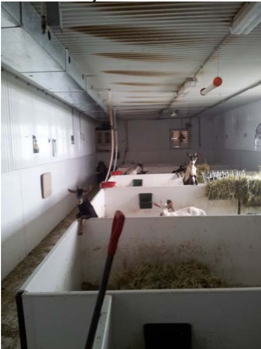
Figure 10 Conduite de distribution à l'intérieur de la pouponnière. Les taches brunes au plafond correspond au panache de distribution d'air. En été l'air frais refroidit le PVC, ce qui crée un peu de condensation et ainsi l'accumulation de poussière sur le revêtement. Les volets sur le mur d'en face sont ouverts par pression positive lorsque le ventilateur du puits fonctionne.
