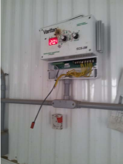
Figure 9 Thermostat électronique contrôlant la vitesse du ventilateur. En ventilation minimale, on fixe le débit minimal en % et le cycle de départ-arrêt se fait en % d'un cycle de 3 minutes.
