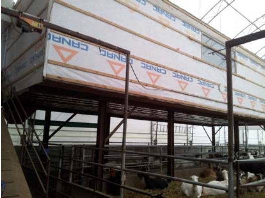
Figure 5 Pouponnière de 40' x 16' x 8' isolée et ventilée mécaniquement aménagé sur pilotis dans la chèvrerie froide (Mégadôme)
