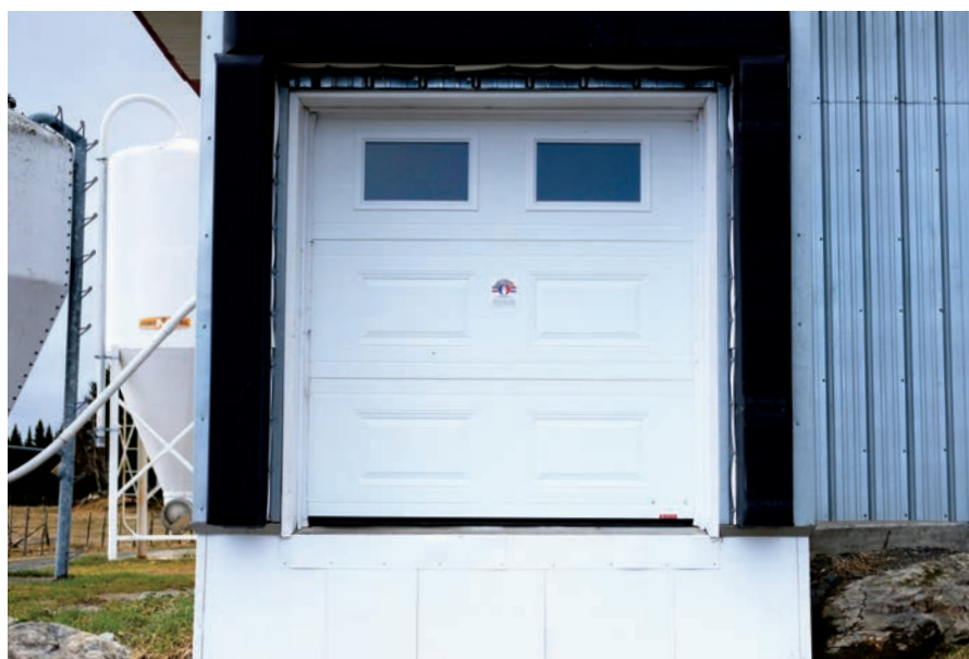
Il a revu et repensé son quai de chargement qui est notamment isolé et lavable.
