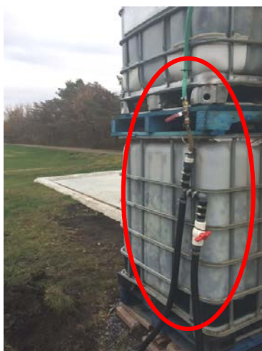
Photo 3 : Dispositif de déviation pour la gestion du débit d'amenée de l'effluent
