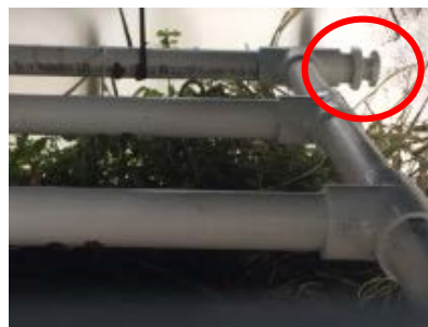
Photo 4 : Bouchon étanche à l'extrémité du dispositif
