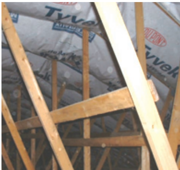
En isolant le sous-toit avec une membrane, on diminue la température dans les salles d'élevage de 4 à 5°C par temps de canicule si l'air frais est puisé dans le grenier.
