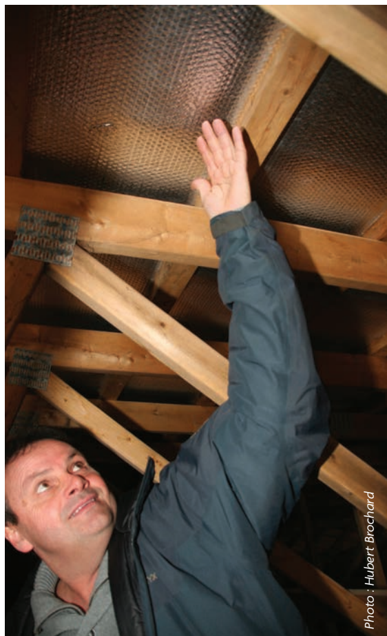
Un petit truc économiquement très utile : cet isolant à bulles apposé sur le côté intérieur de la toiture.
