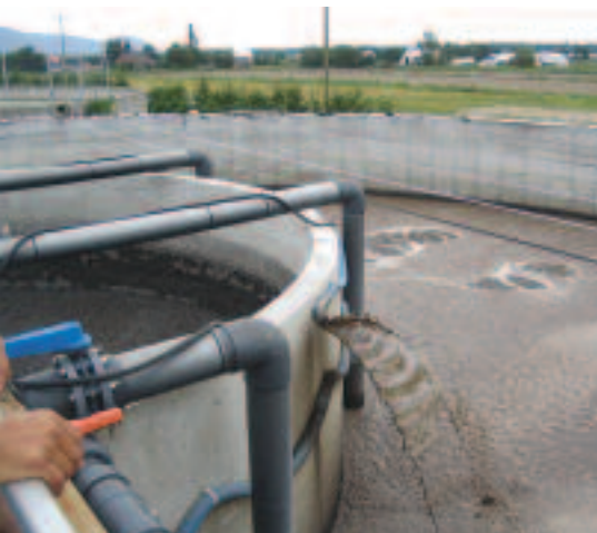
Après la première filtration, le lisier va dans le décanteur, à gauche, puis le liquide surnageant va dans le bioréacteur, à droite, où circule de l'air, 16 heures par jour.
