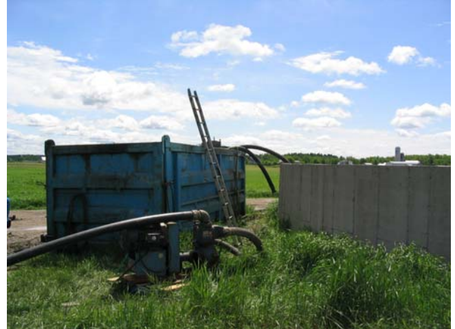
Réservoir tampon du lisier brut
